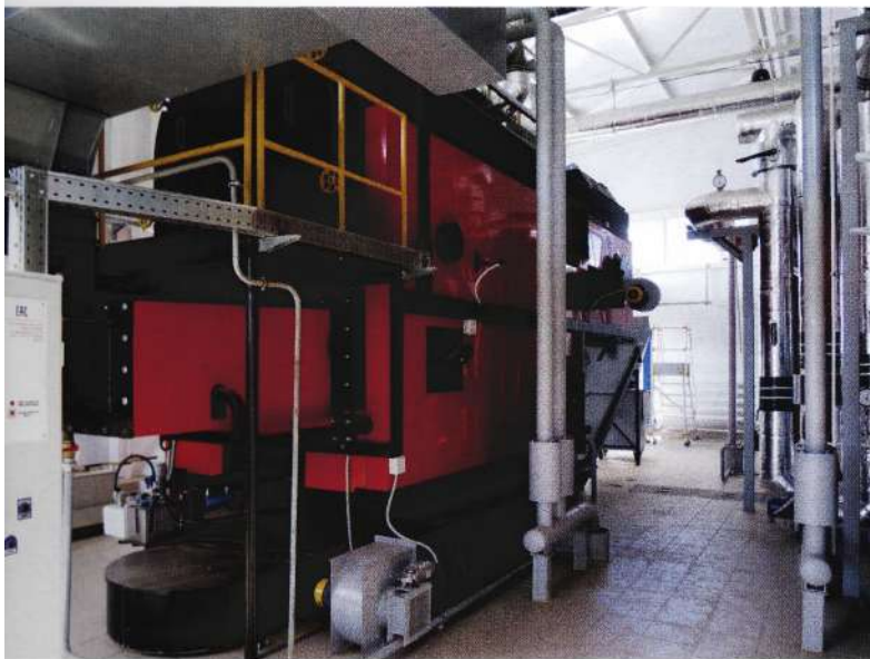
В помещении котельной
