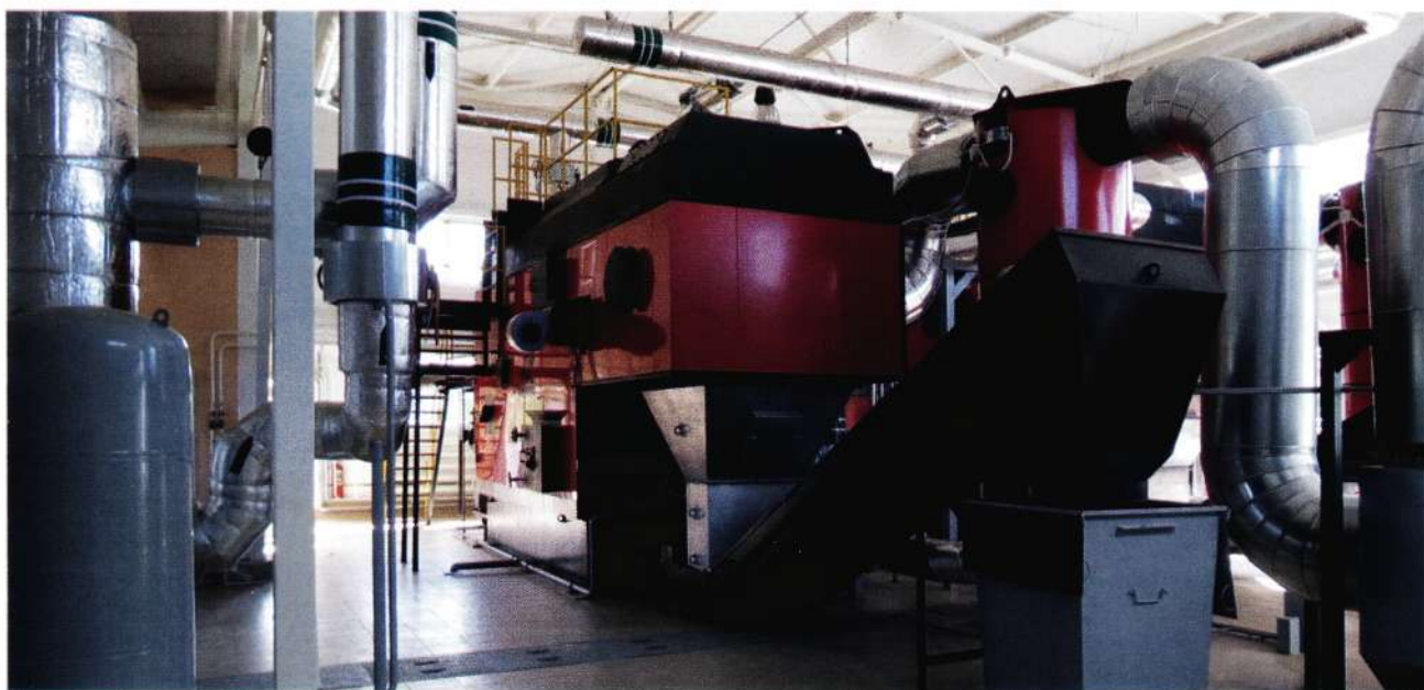
Котлы «Комконт» хорошо зарекомендовали себя на многих котельных
