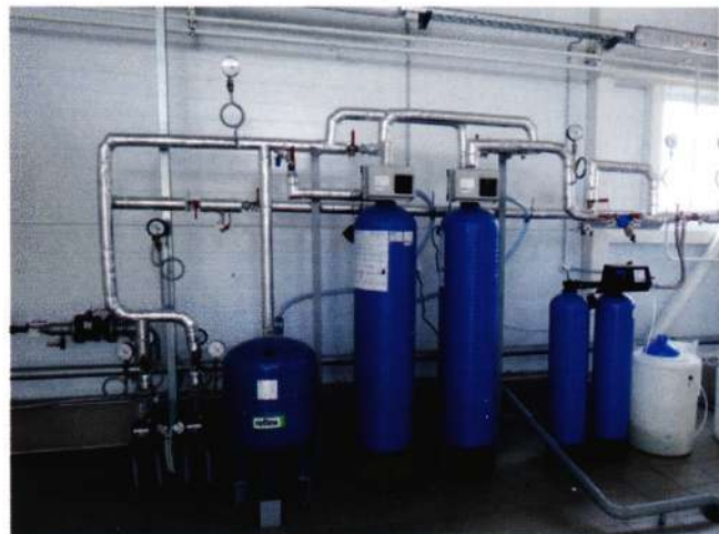
Качественная химводоподготовка продлевает срок службы котельного оборудования
